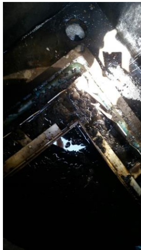
ลักษณะในบ่อดักตะกอน 1
