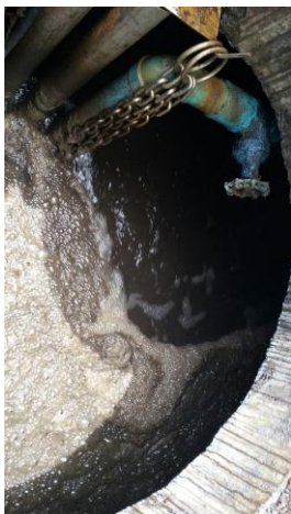
ภายในบ่อเติมอากาศ
