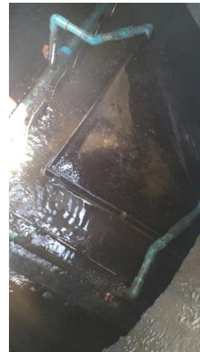
ลักษณะในบ่อดักตะกอน 2
