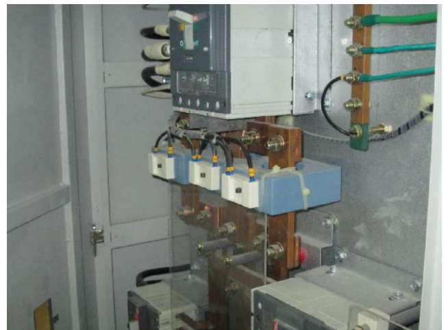
ภาพ : Main Plug-In Shaft Room FL. 1
