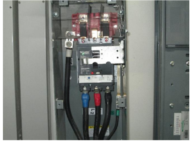
ภาพ : Main Plug-In Shaft Room FL. 16
