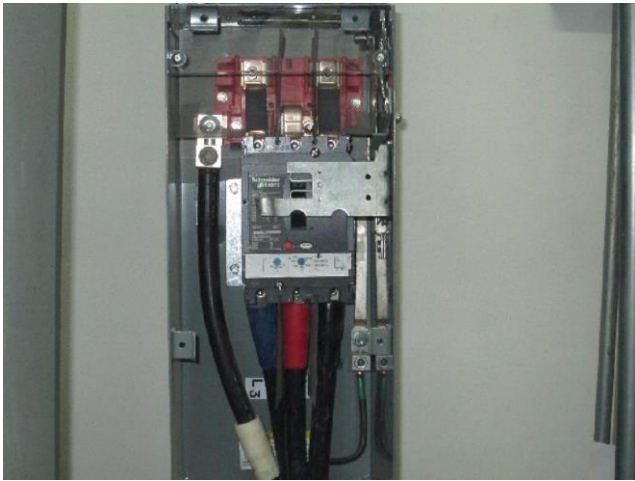
ภาพ : Main Plug-In Shaft Room FL. 17
